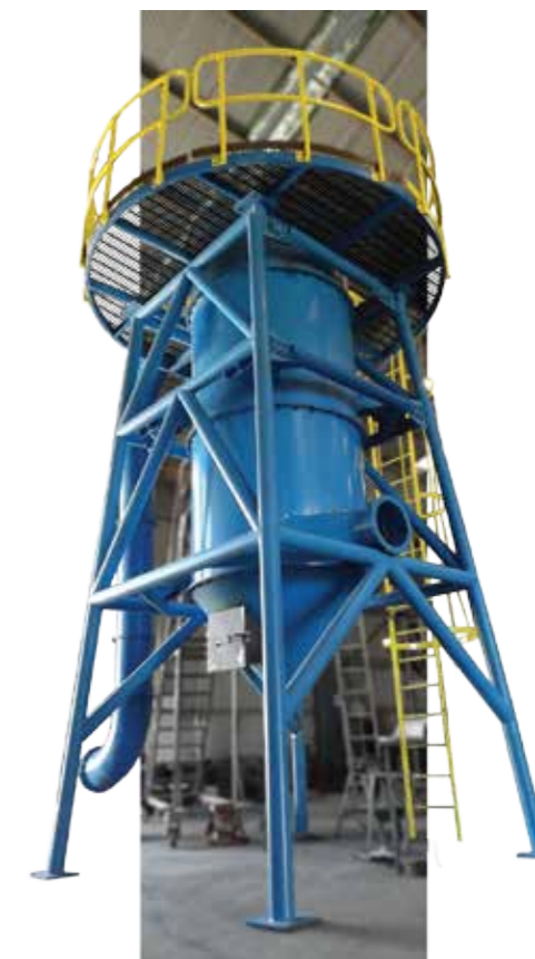
Sistema de extracción de polvo / Minera Michilla
